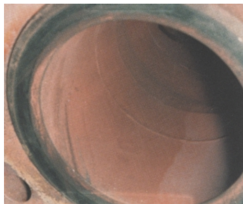
Konserviertes Rohrstück – Schutzwirkung im entleerten Zustand
