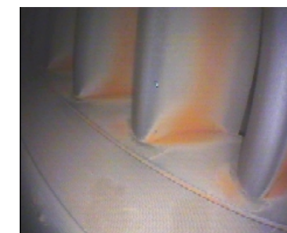
Turbinenschaden ohne Konditionierung
