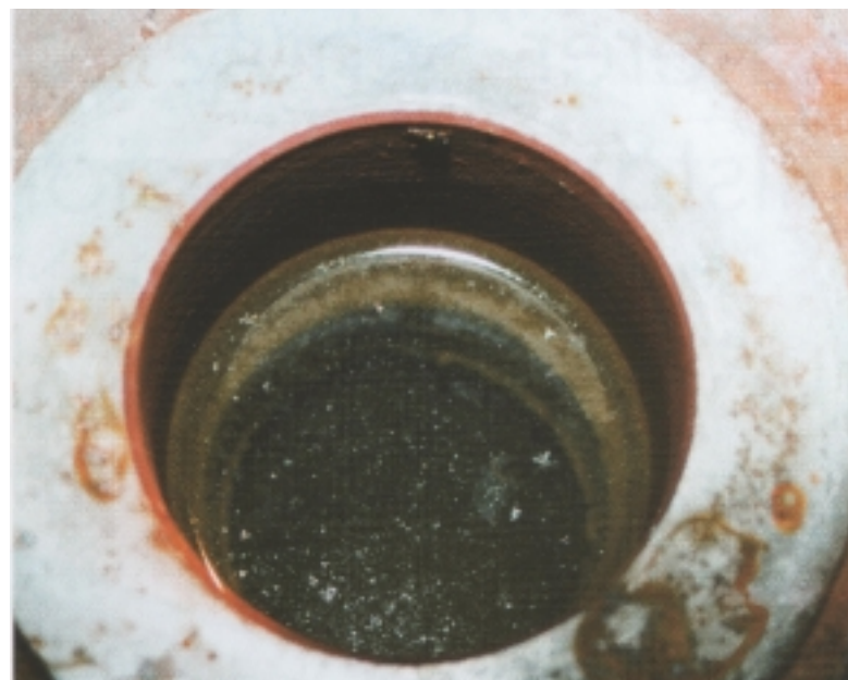
Konserviertes Rohrstück, Stand acht Jahre mit Wasser gefüllt
